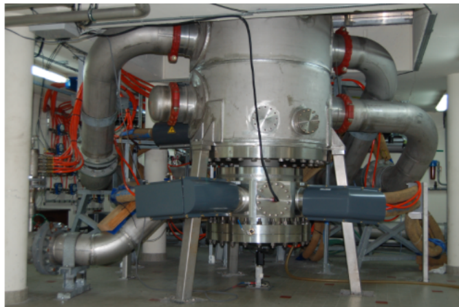
Système de refroidissement des aimants (sous-sol)
